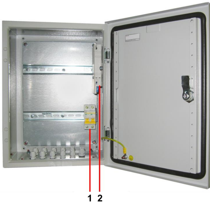
Рис.25 Уличная станция OS-341, внутренние элементы
